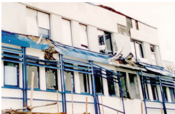
Zgrada Pedijatrije oštećena u granatiranju
